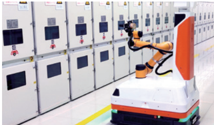
高压配电柜操作
