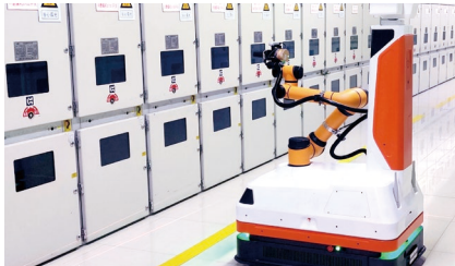
高压配电柜操作
